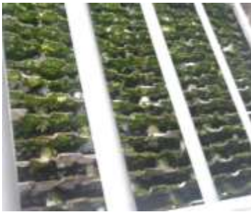
▷ Cooling tower packed bed 에 축적된 이끼류
